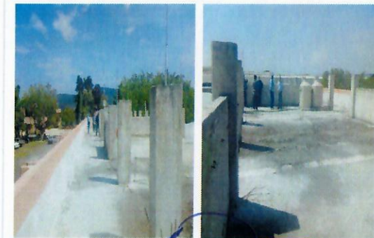
F5: Estado en que estaba la Planta Alta.
