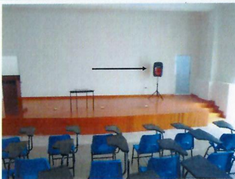
F17: Bafle instalado en el Auditorio.
