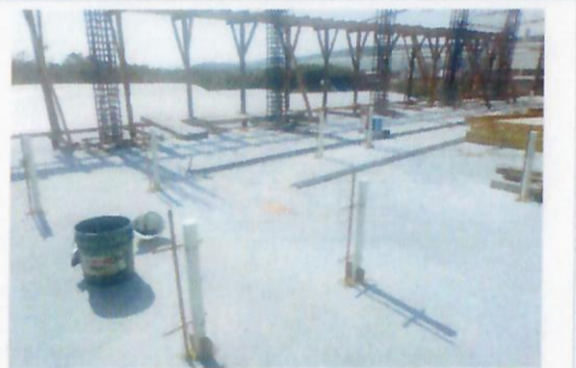
F17: Pasos en losa y colocación de tubería de pvc y cobre.
